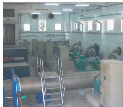
Stația de la Mărtinești: stația de pompare echipată cu instalații electrice și hidraulice noi
