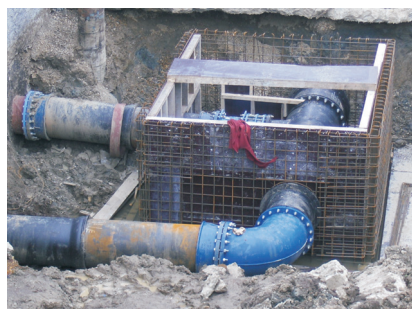
Stația de la Mărtinești: Lucrări de reabilitare a unui cămin de vane (separare rezervor)
