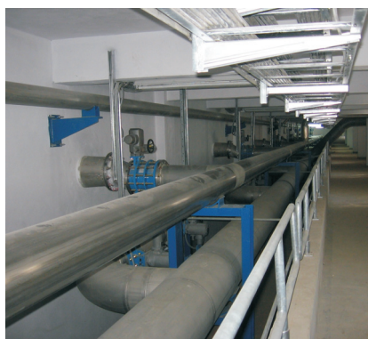
Stația de la Mărtinești: galeria cu noua instalație hidraulică
