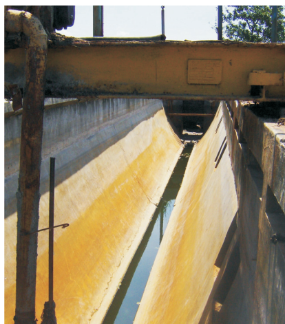
Stația de epurare: deznisipator golit, aflat în curs de curățare și demontare a echipamentelor
